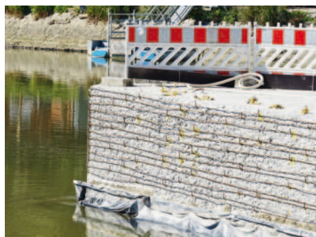
Freigelegte Bewehrung am Wehrpfeiler
